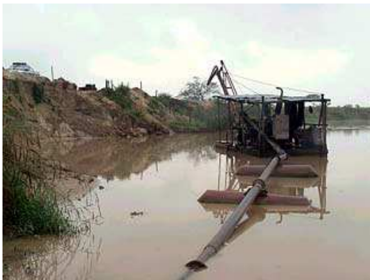
Figura 2: Margem desmatada, com erosão e causando assoreamento na área de extração de areia
